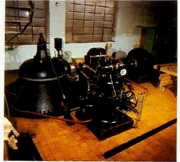
Strojovna malé vodní elektrárny
