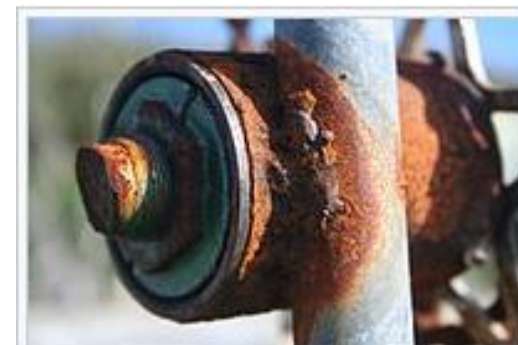
Koroze je redoxní reakce s nepříjemnými dopady pro průmysl
