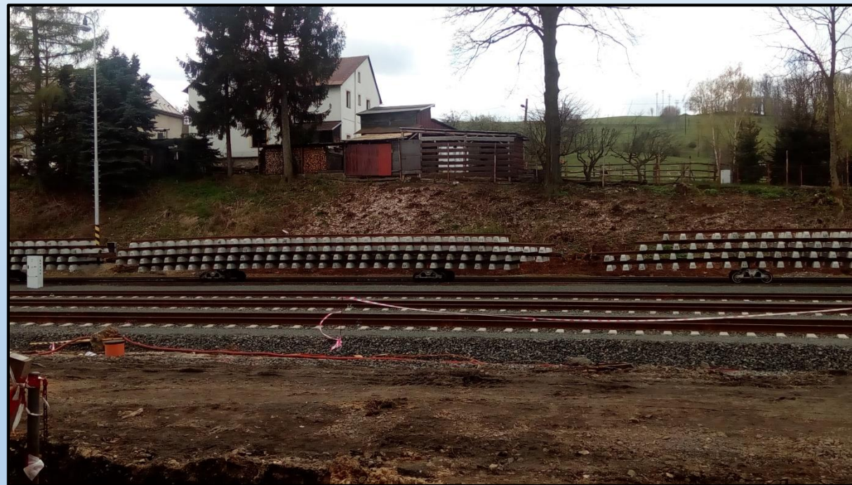
b) Kolejnice jsou v polovině „vagonu“ prohnuty nahoru
