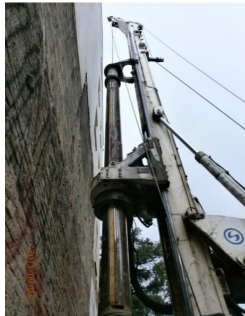
Vrtání piloty vedle stávající budovy – osa min 600 mm, spíše však 800 mm od líce zdi
