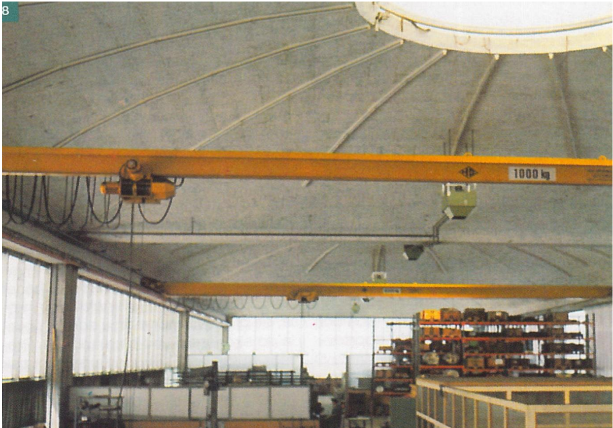
Střecha haly Moser AG, Lysach – 10 kopulí s rozpětím 22 x 22 m, tloušťka 80 mm
