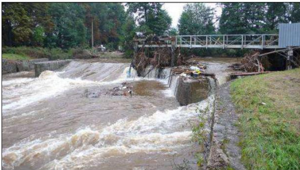
Obr.28 Jez umístěný pod dolním okrajem obce či města nejen působí jako migrační překážka, ale také může posilovat zpětné povodňové vzdutí do zástavby. Tento efekt může sílit, pokud průtočný profil jezu omezí bariéra ze splávi. Jez na dolním okraji Frýdlantu po povodni v srpnu 2010.
