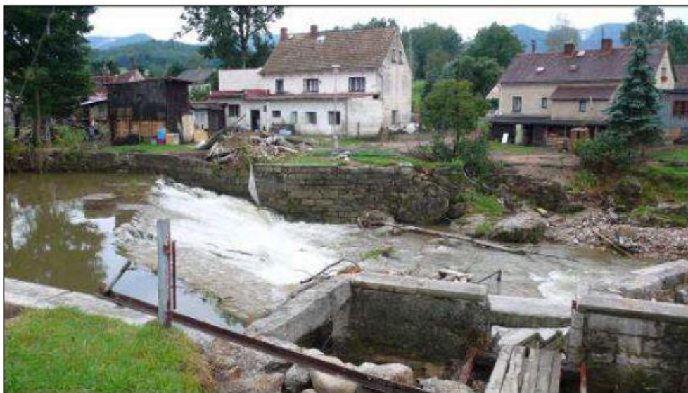
Obr.30 Kombinace jezu a nevhodného umístění zástavby v říční nivě může zhoršit vyplavení domů. Hejnice na Smědě po povodni v roce 2010.
