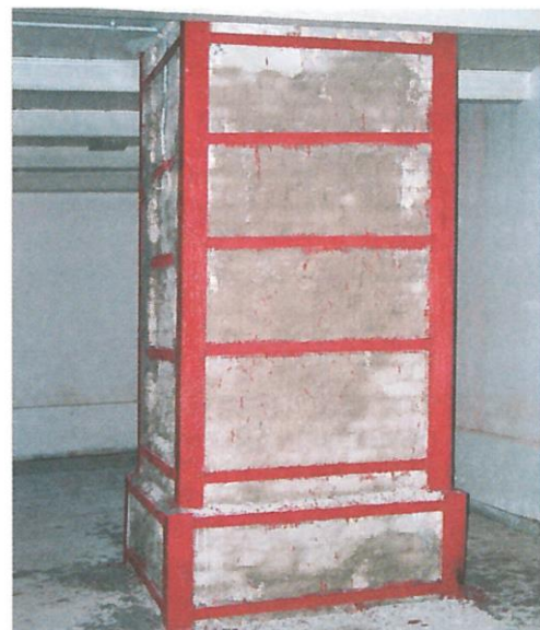
Obrázek 4.92 Ocelová bandáž sloupu
